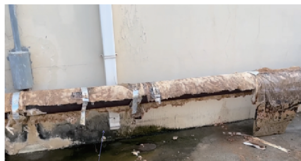
原保温材料岩棉塌陷破损严重
